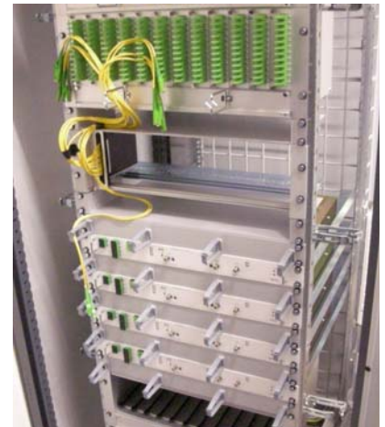
FTTB-Pilotprojekt, Hub bei Sinergy
